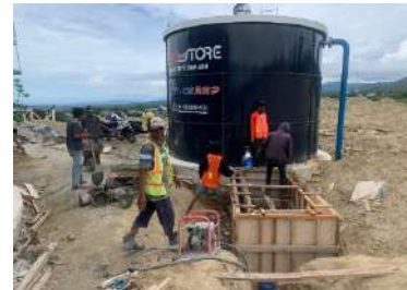
Pek.SPAM/Water Tank induk Zona 2A1
